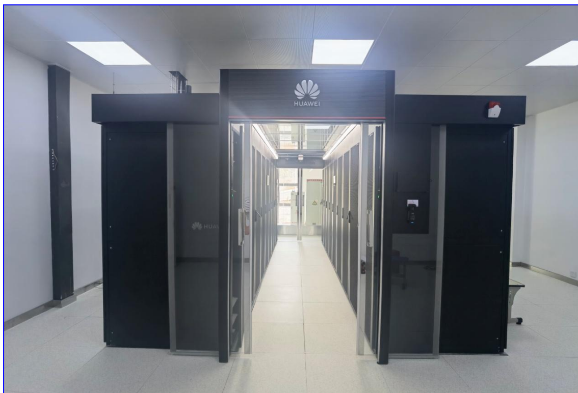
图 5：学校中心机房
